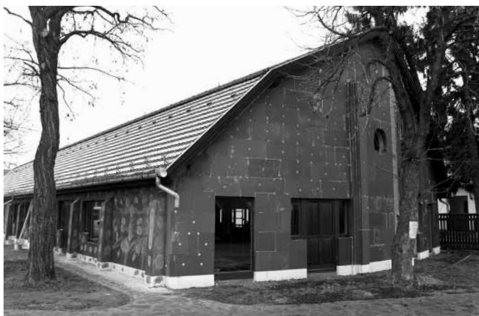
Zajlik a Táncpajta hőszigetelése
